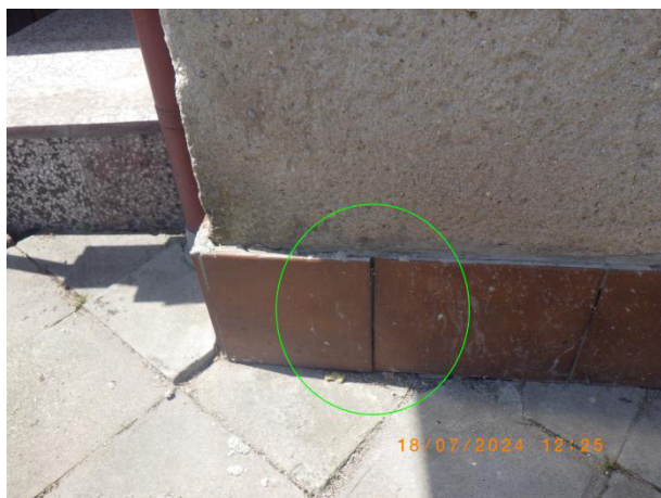
foto 92 poškozený obklad soklu
