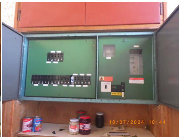
foto 02 1.01 průjezd původní elektroinstalace
