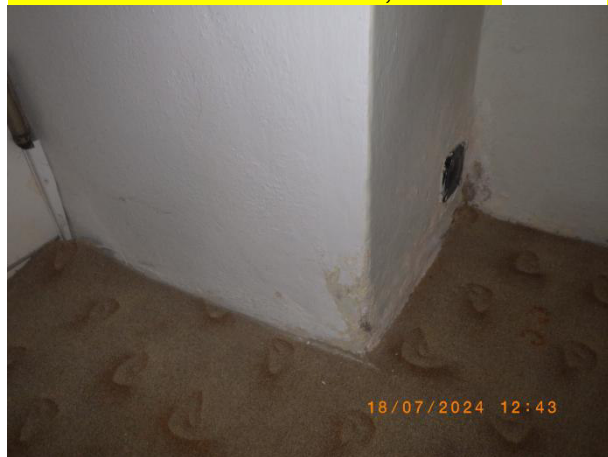
foto 25 1.04 ložnice poškození povrchů
