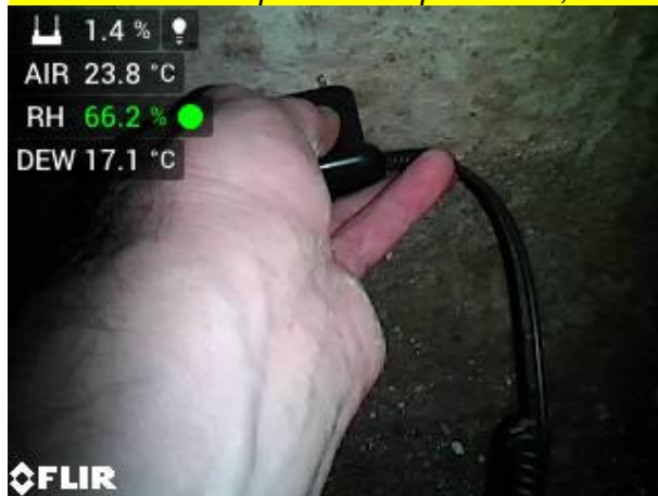
foto 112 0.02 sklep2 vlhkost 1,4 % hm
