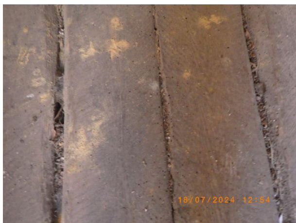
foto 39 1.10 chlév poškození podlahy
