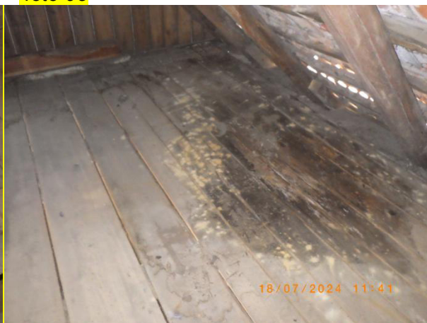
foto 97 poškození záklopu stropu
