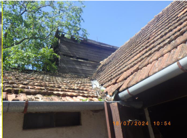
foto 118 krytina zarůstá mechem, zanesený žlab
