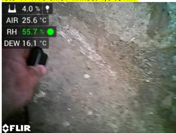
foto 43 1.10 chlév podlaha vlhkost 4 % hm
