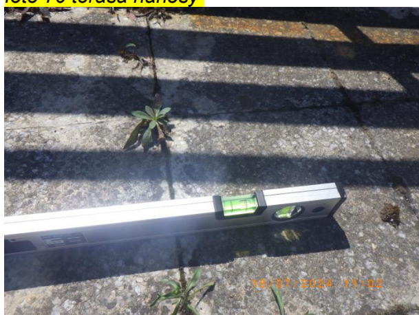
foto 72 + 73 terasa zarůstá mechem, trávou
