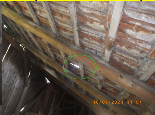
foto 120 stodola netěsnost krytiny
