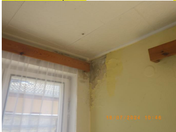
foto 31 1.07 předsíň poškození povrchu
