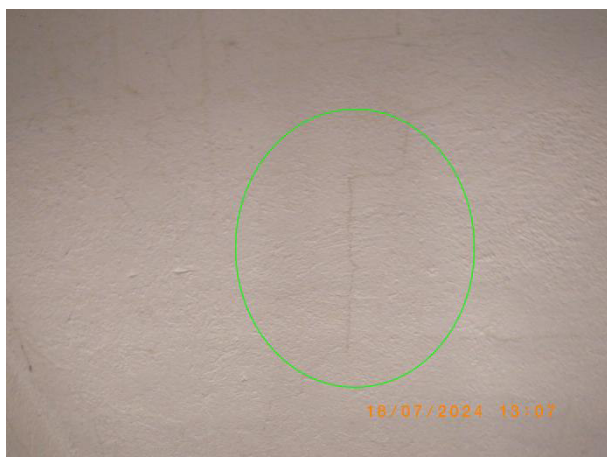
foto 57 1.12 spíž trhliny strop
