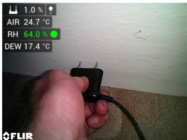
foto 21 1.04 ložnice vlhkost 1 % hm
