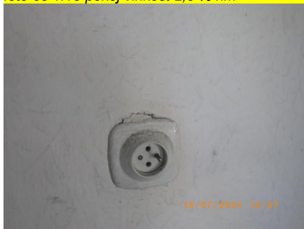
foto 65 poškození povrchu, původní elektroinstalace
