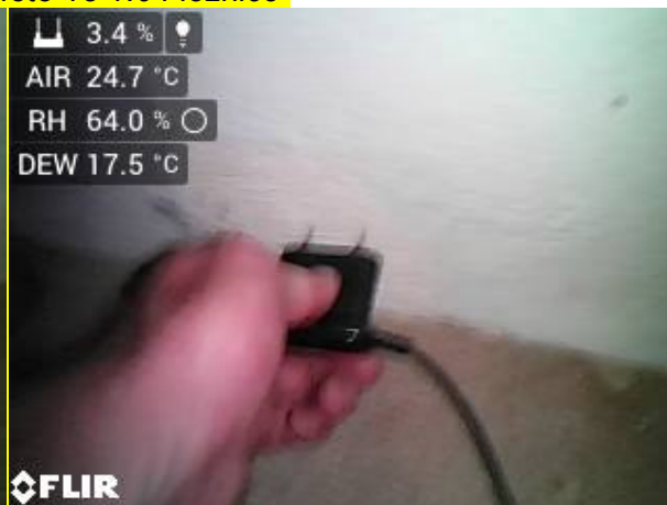
foto 20 1.04 ložnice vlhkost 3,4 % hm
