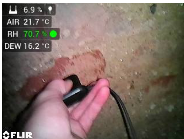
foto 108 0.01 sklep 1 vlhkost 6,9 % hm
