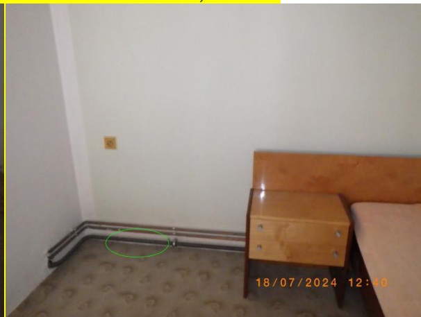
foto 26 potrubí plynu není označeno žlutou barvou
