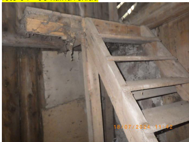
foto 96 dřevěné schodiště bez zábradlí
