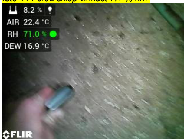
foto 116 0.02 sklep2 podlaha vlhkost 8,2%hm
