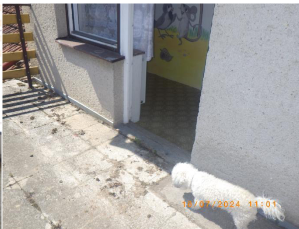
foto 69 nevhodně řešený detail balkonových dveří
