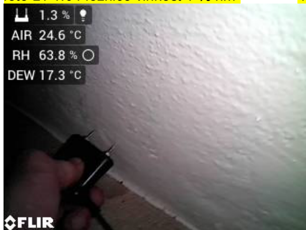
foto 23 1.04 ložnice vlhkost 1,3 % hm
