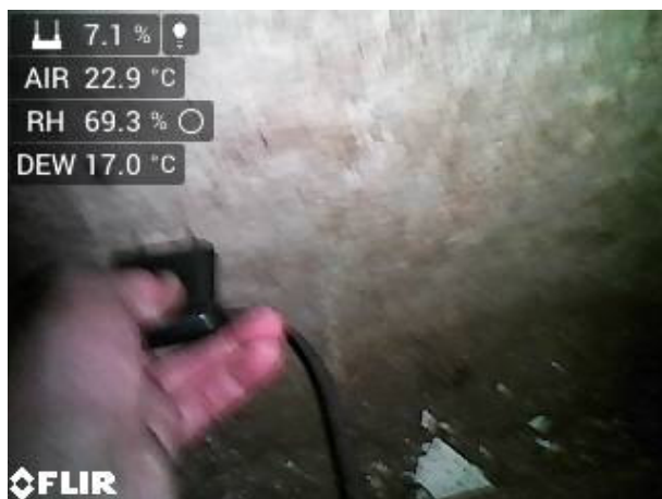
foto 114 0.02 sklep vlhkost 7,1 % hm
