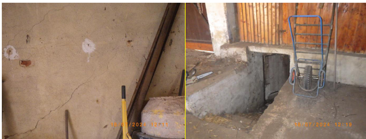
foto 100 trhliny zdivo od souseda
