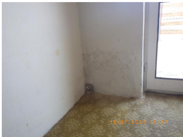
foto 68 2.03 pracovna poškozený povrch
