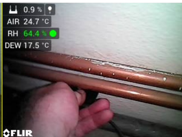
foto 22 1.04 ložnice vlhkost 0,9 % hm
