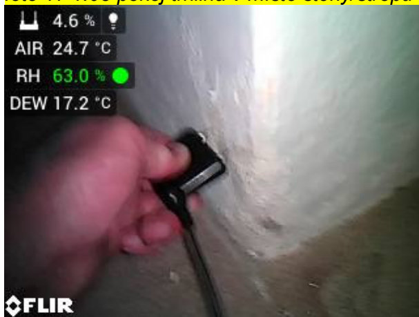
foto 19 1.04 ložnice vlhkost 4,6 % hm
