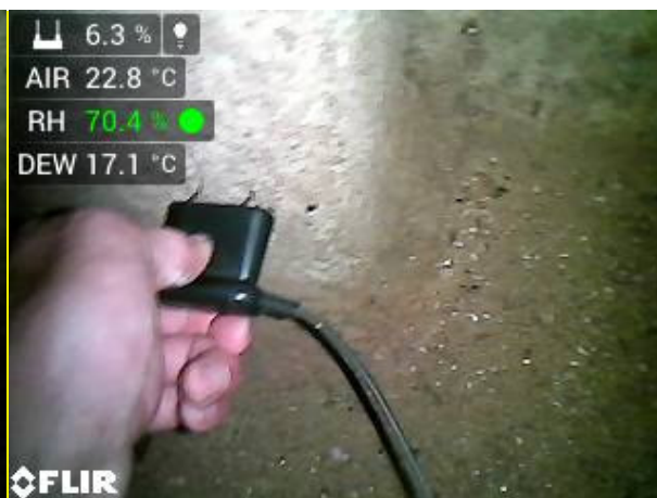
foto 115 0.02 sklep2 vlhkost 6,3 % hm
