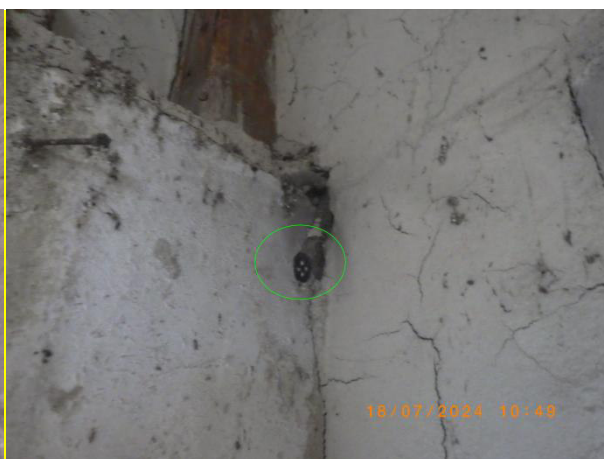
foto 40 1.10 chlév obnažený kabel
